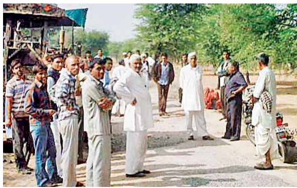
खिरोड़, तारपुर मार्ग पर सड़क निर्माण को रुकवाते ग्रामीण व बनाई जा रही घंटिया सड़क।
